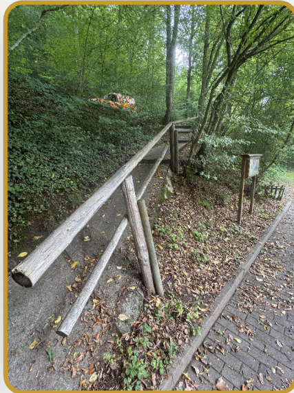
Die Böschung hat sich gesetzt, das Gelände lässt sich nicht mehr dauerhaft sicher befestigen.
